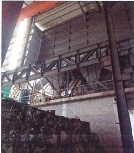
炼钢车间布袋除尘器
